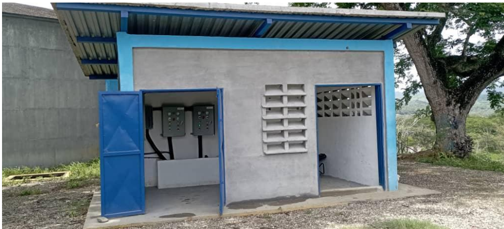
CUARTO DE CONTROL
